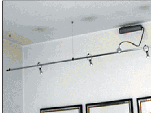
Bild 12 | Decke mit Verfärbungen oberhalb der Halogenstrahler (Wohnung F).
