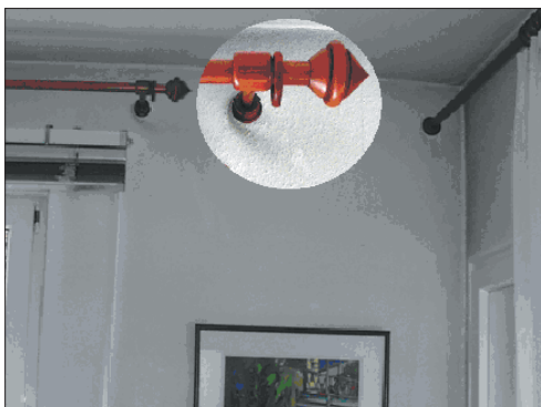
Bild 10 | Wand und Decke (Wohnung G) mit deutlichen Verfärbungen im Bereich der Gardinstange (siehe Vergrößerung).
