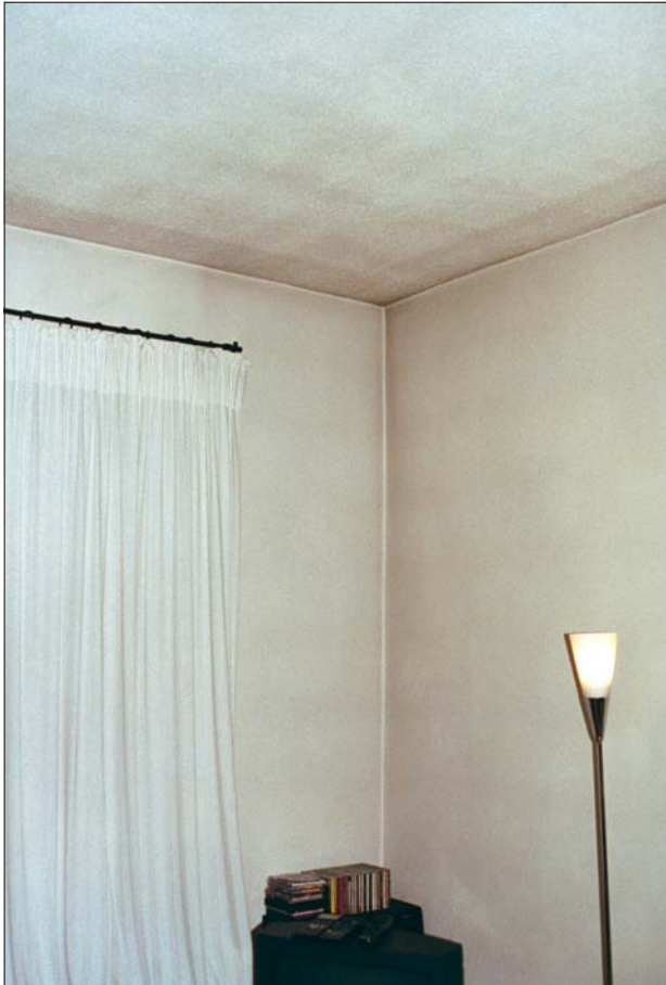
Bild 1 Massive Schwarzstaubablagerungen im Wand- und Deckenbereich eines Wohnzimmers.
